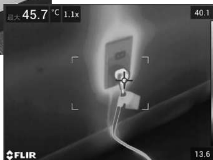
赤外線サーモグラフィによる写真(弊社調査の写真) (中央の白のカギ「」内にある十字の中心当たりの温度が45.7°C)
