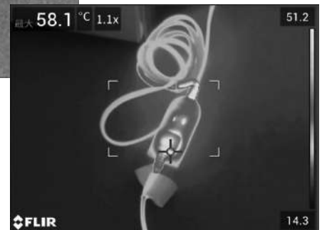
赤外線サーモグラフィによる写真(弊社調査の写真) (中央の白のカギ「」内にある十字の中心当たりの温度が58.1°C)
